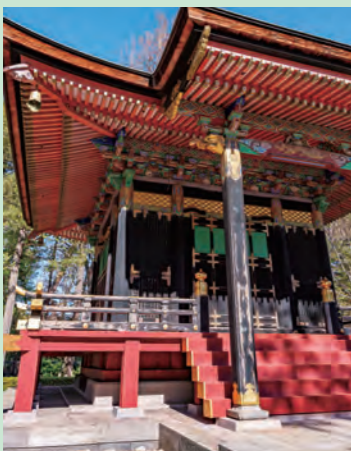
令和8年度修繕工事予定の旧自証院霊屋(向拝柱や高欄の漆塗りが劣化している様子)
